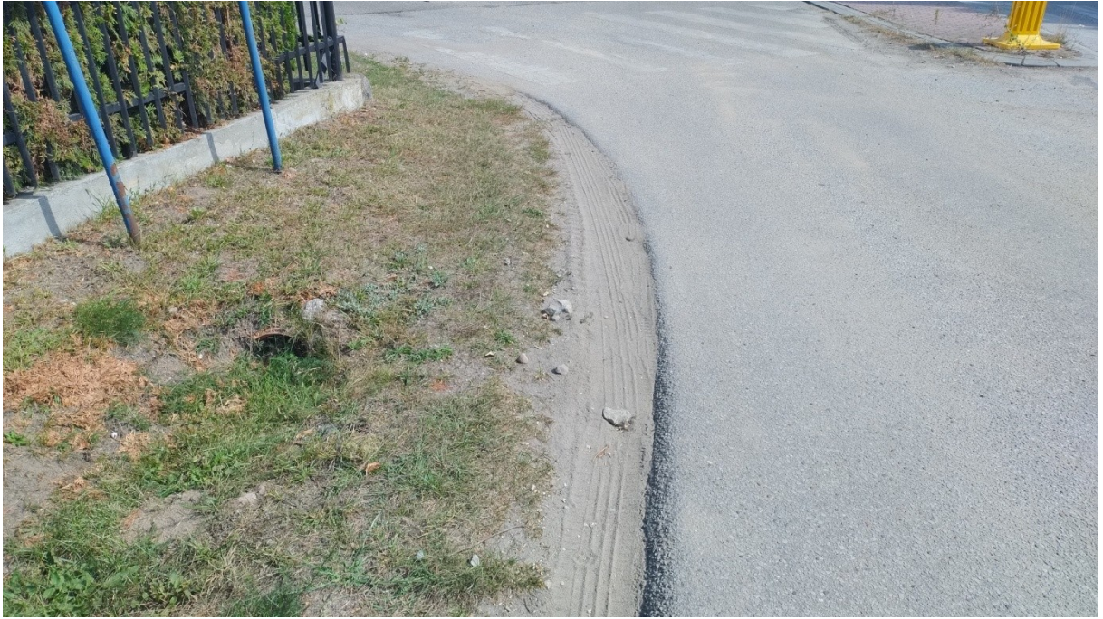
Fot. 25 Droga powiatowa 1337 Gózddek w stronę Łomnicy, stan przepustu pod jezdnią drogi powiatowej.
