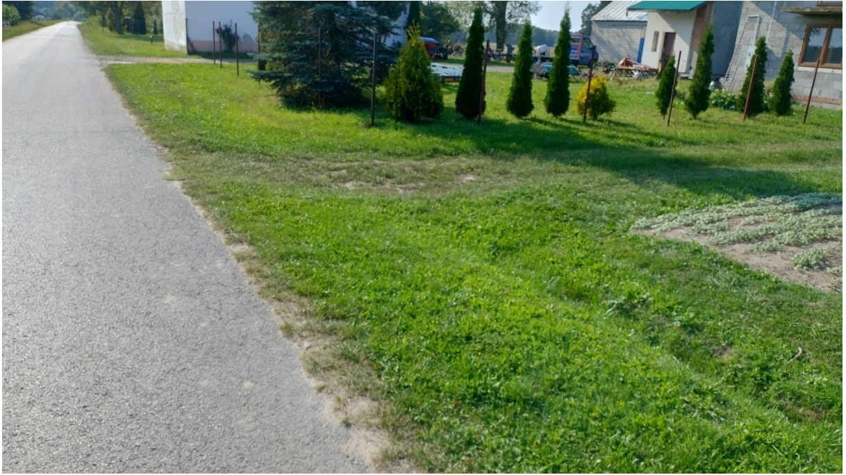
Fot. 9 Droga powiatowa 1364W Władysławów, stan rowów odwadniających.
