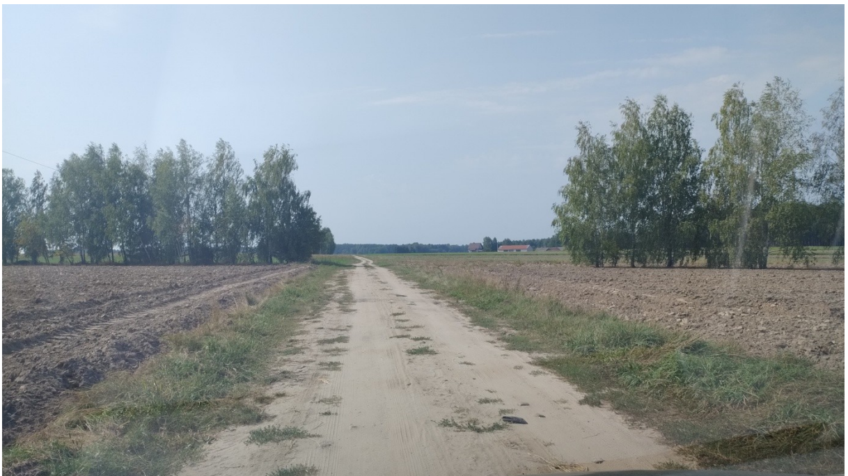
Fot. 12 Droga powiatowa 1365W Stary Kębłów, nawierzchnia gruntowa.
