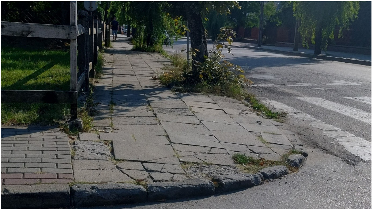
Fot. 16 Droga powiatowa 1336W ul. J. Piłsudskiego, stan chodników w stronę ul. Długiej (wojewódzkiej 807).
