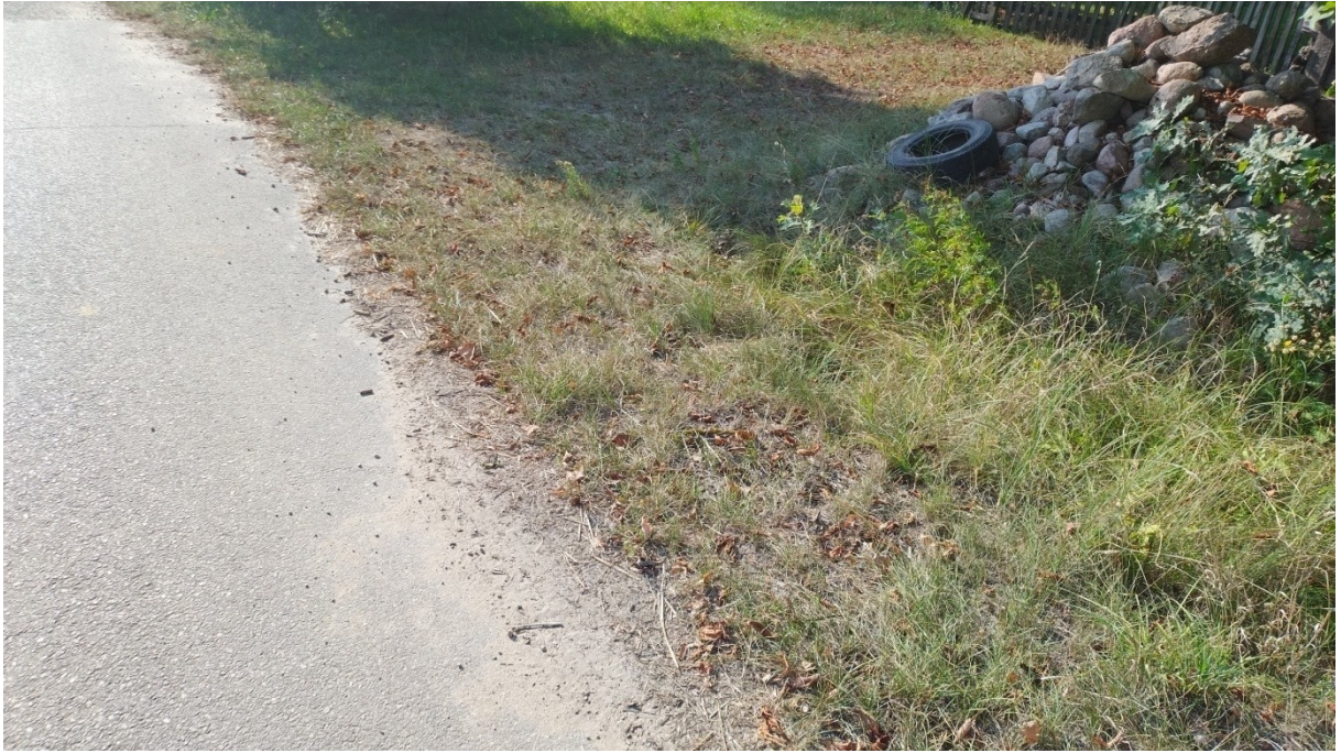
Fot. 15 Droga powiatowa 1338W Kalinów, stan rowów i zjazdów na posesje.
