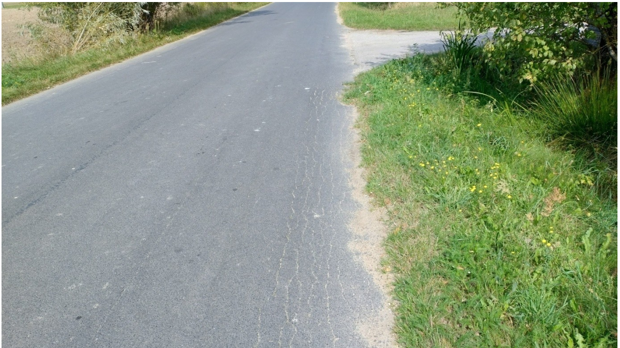
Fot. 20 Droga powiatowa 1342W Piastów, stan nawierzchni oraz pobocza.
