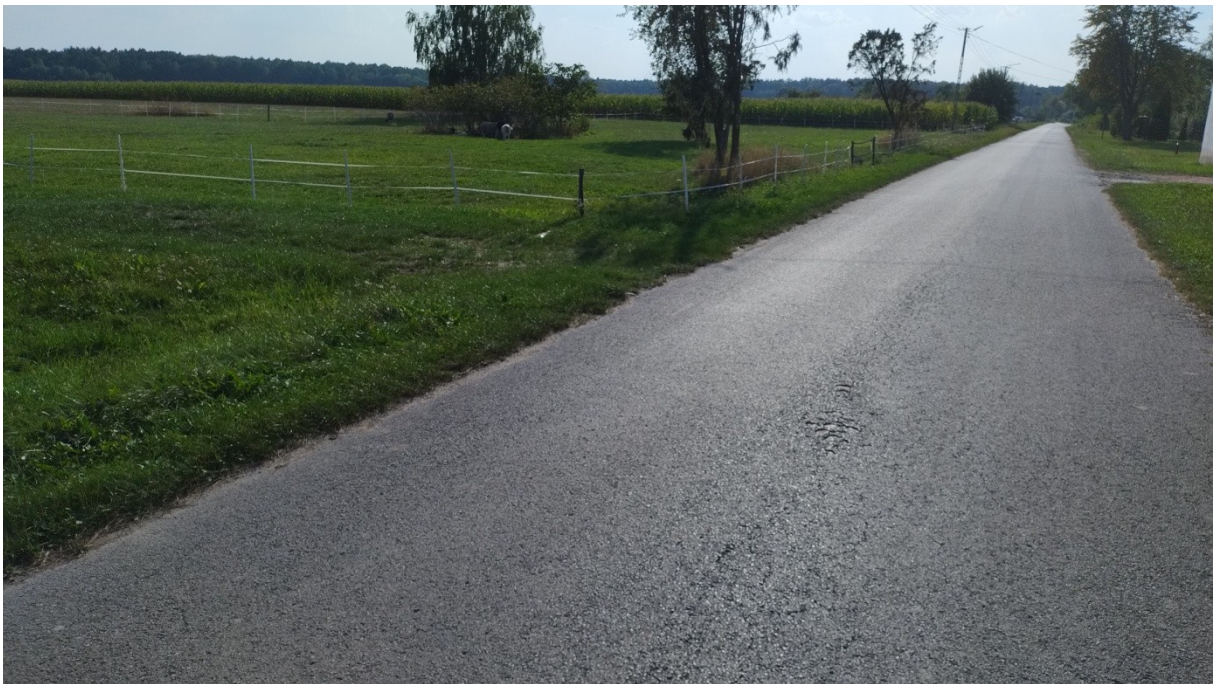
Fot. 14 Droga powiatowa 1338W Kalinów, stan rowów i zjazdów na posesje.
