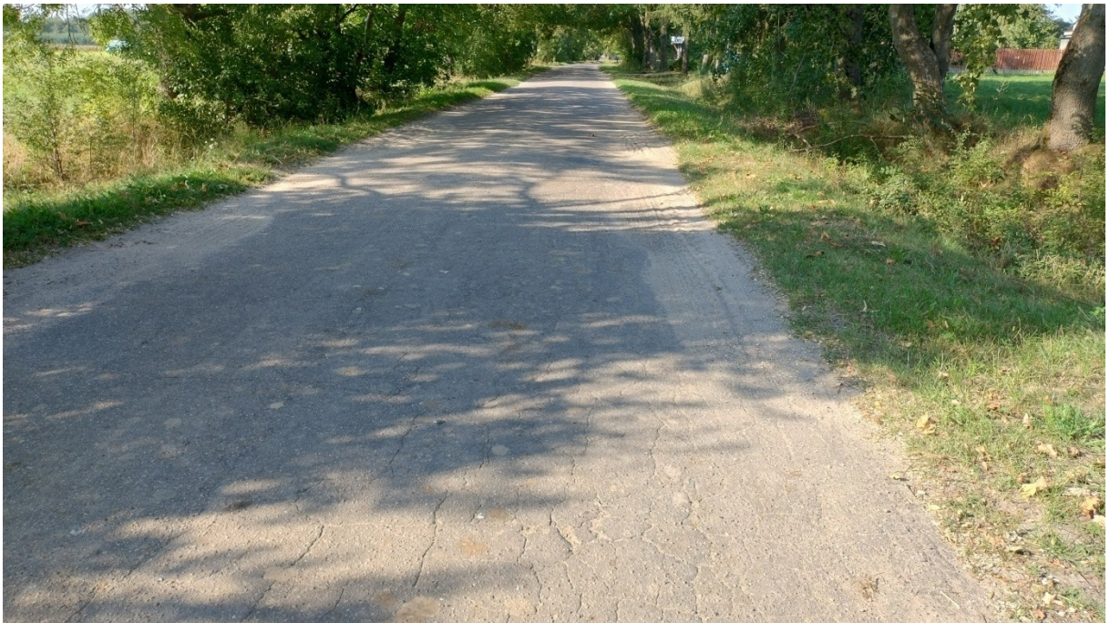
Fot. 22 Droga powiatowa 1338W Stary Goniwilk, stan nawierzchni jezdni.
