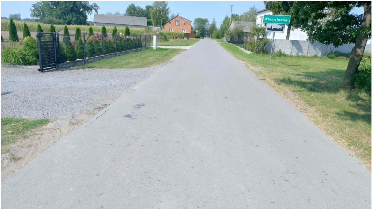
Fot. 10 Droga powiatowa 1364W Władysławów, stan rowów odwadniających.
