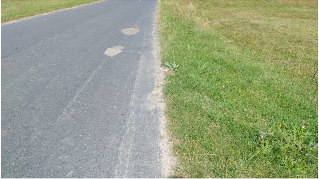
Fot. 19 Droga powiatowa 1342W Piastów, stan nawierzchni oraz pobocza.
