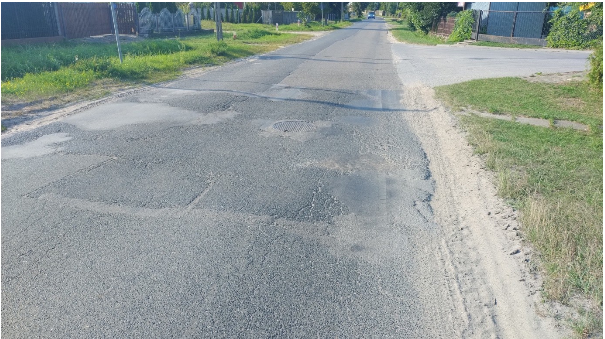
Fot. 3 Droga powiatowa 1366W ul. R. Traugutta, stan nawierzchni bitumicznej.
