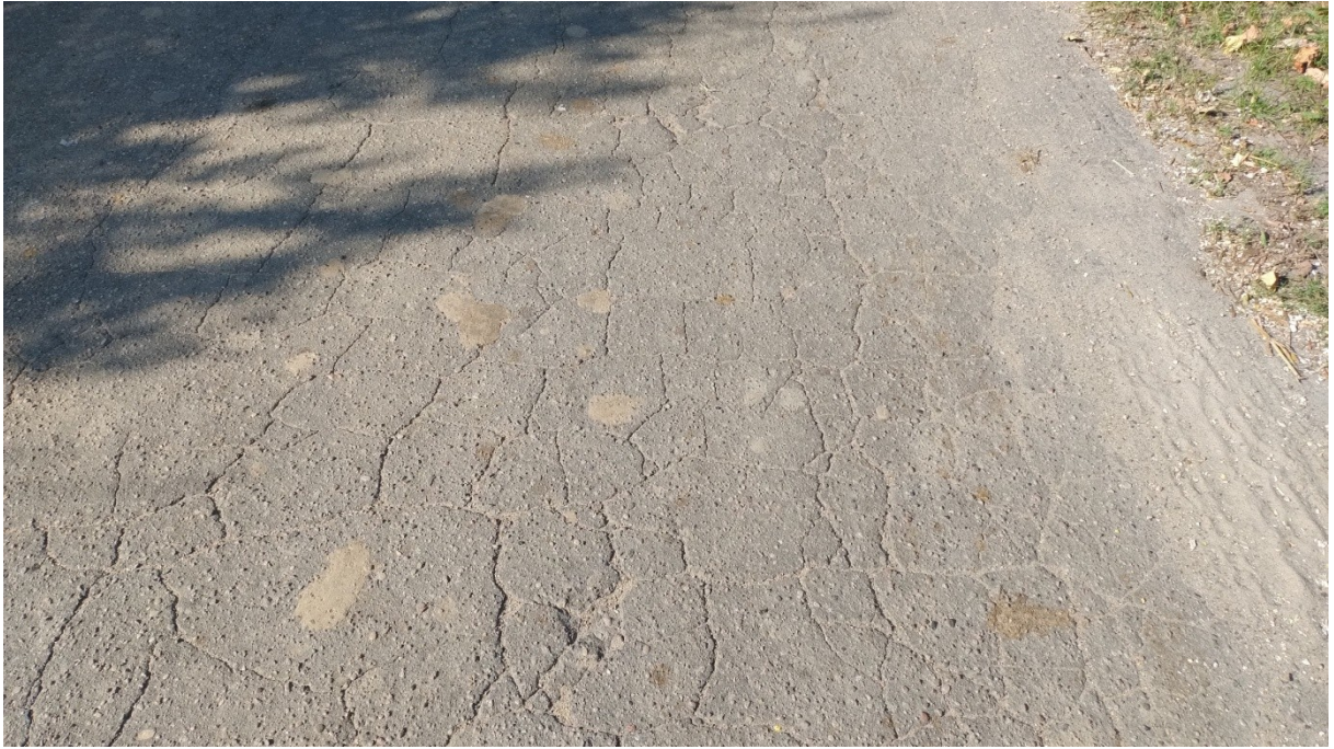
Fot. 21 Droga powiatowa 1323W Stary Goniwilk, stan nawierzchni jezdni.
