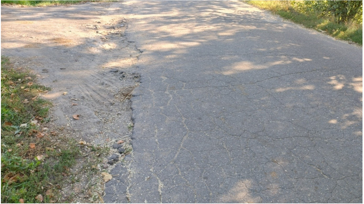
Fot. 23 Droga powiatowa 1338W Stary Goniwilk, stan nawierzchni jezdni.
